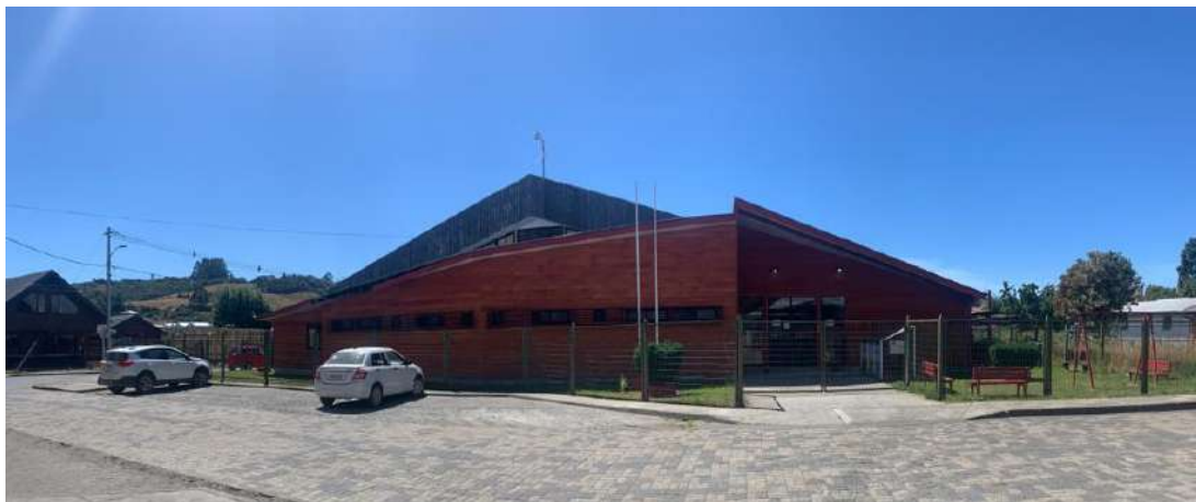
Fotografías de situación actual, en deterioro. El proyecto de Conservación conservará su imagen actual, cambiando todos sus revestimientos
